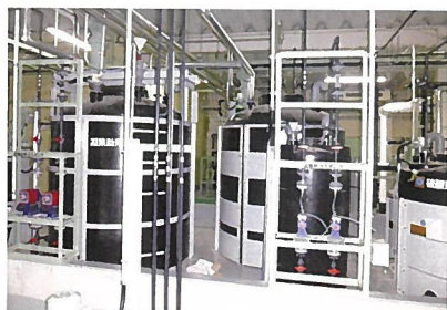
浸出水処理施設内部
